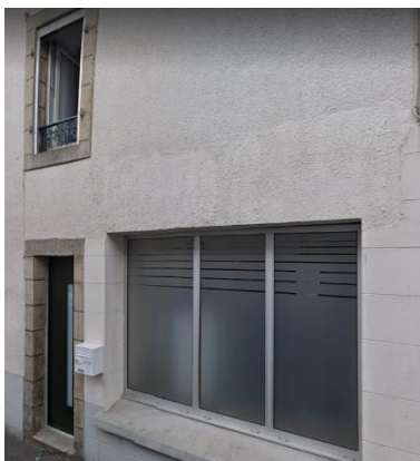
Le percement des nouvelles ouvertures non adaptées aux proportions des fenêtres existantes (source google street-view)
